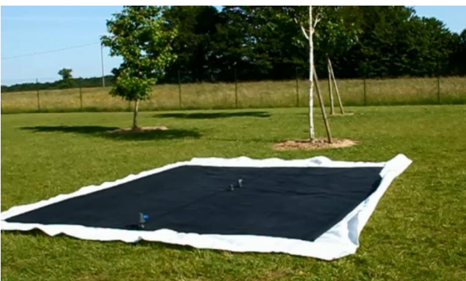
3. Positionnement de la citerne de façon à faire disparaître les plis et montage de la vanne de vidange
