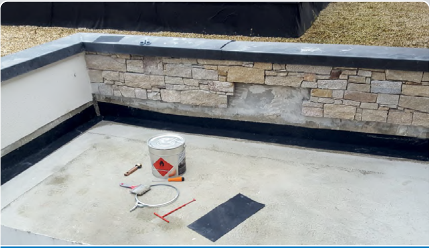
Étanchéité des casquettes en béton
